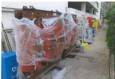
หม้อแปลงไฟฟ้า จำนวน 2 ตัว
