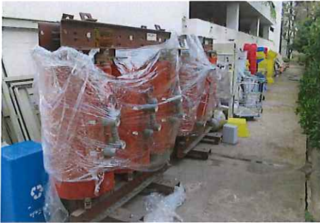
หม้อแปลงไฟฟ้า จำนวน 2 ตัว
