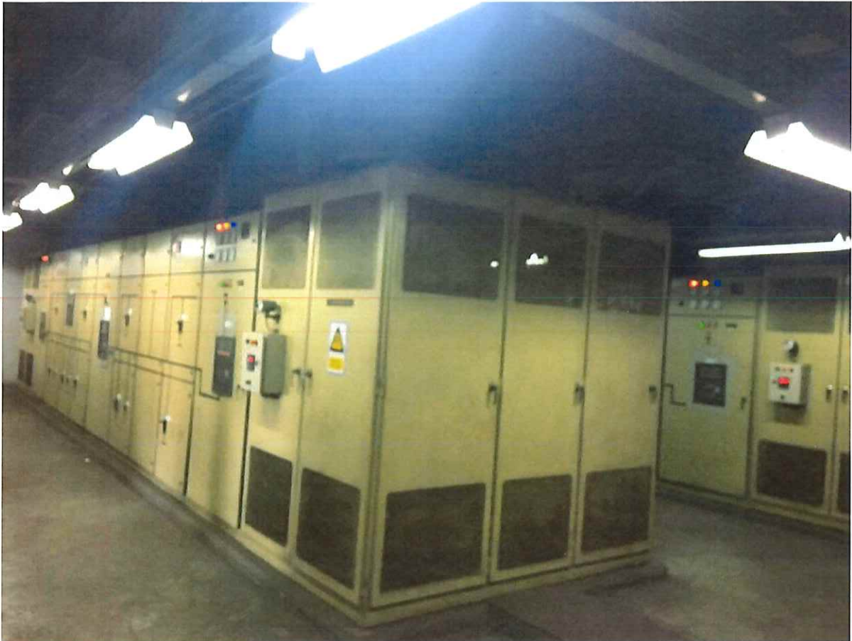
ภาพถ่ายห้อง FIRE PUMP และบริเวณพื้นที่หน้าห้อง ชั้น BASEMENT อาคารจอดรถ
