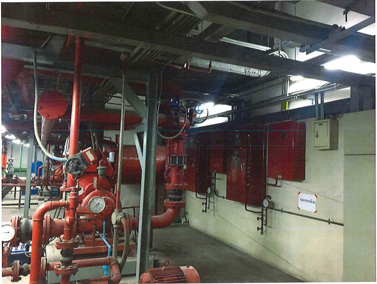
ภาพถ่ายห้อง FIRE PUMP และบริเวณพื้นที่หน้าห้อง ชั้น BASEMENT อาคารจอดรถ
